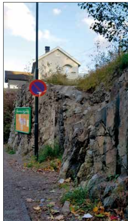
Der hvor det tidligere var en liten trapp i fjellet med gelender, er det nå en bratt fjellskrent.
